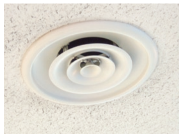
天井の吹き出し口
