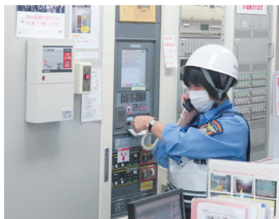
防災センター
